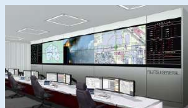
▲ 消防システム
