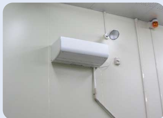
空調機器評価試験室内に設置した家庭用エアコン
