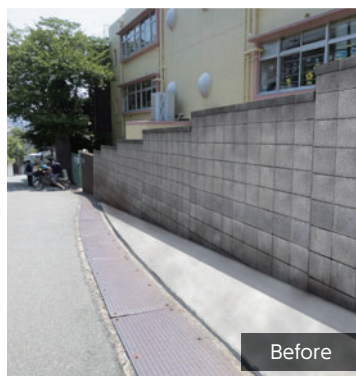
ブロック塀（改修前）
