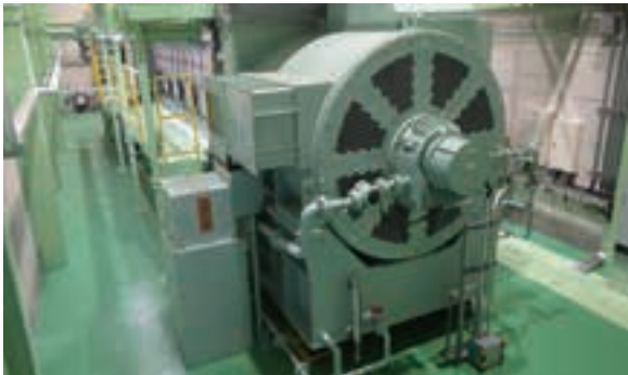
コージェネレーションシステム
