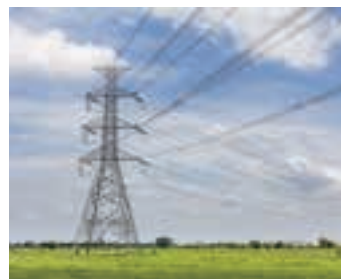
架空送電線と鉄塔
