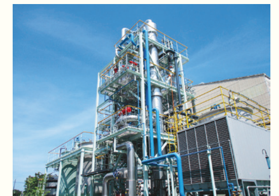
排水中のアンモニア低減を目的としたアンモニアストリッピング設備
