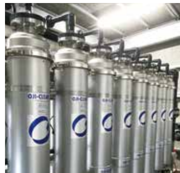
排水処理システム
