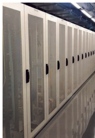
第2期工事後の吹きおろし 空調を備えたサーバ室
