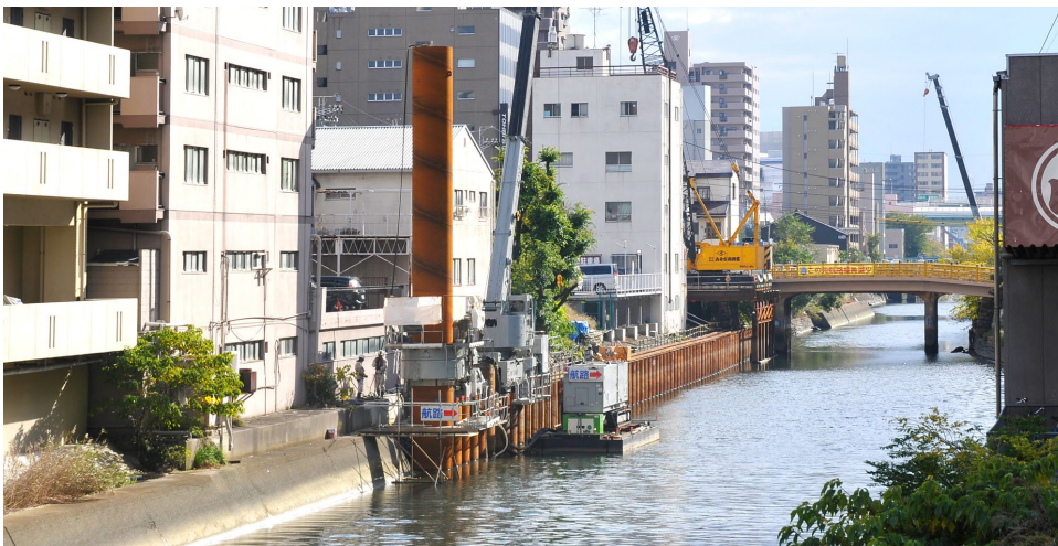
「ジャイロプレス工法」と「GRBシステム」による鋼管杭の回転切削圧入
