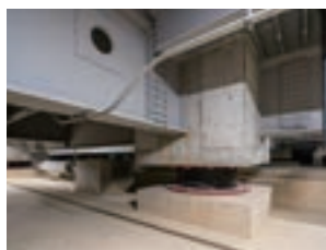
免震ダンパー、免震ゴム (大阪・茨木4号配送センター)
