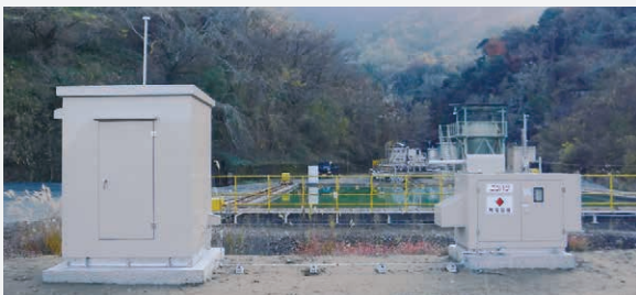
新設の非常用発電機
