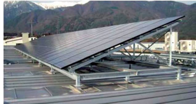
DDS駒ヶ根工場(20kW)(2008年度稼働開始)
