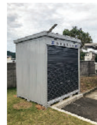
防災蓄電倉庫設置事例
