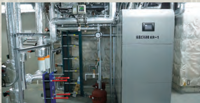
従来捨てられている温排熱を利用する吸着式冷凍機
