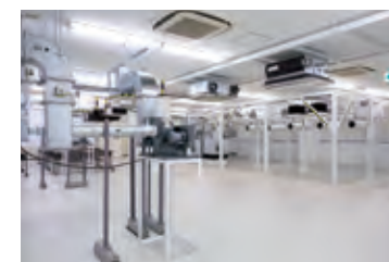
空調・電気の体験型研修室
