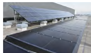
太陽光発電設備(厚木地区)
