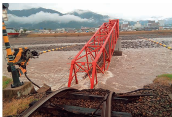
崩落した橋台と傾いた橋脚
