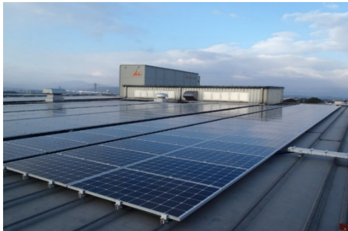
（井村屋株式会社本社工場 三重県津市 発電容量：551.44kW）
