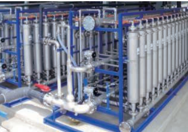
工業用水製造システム
