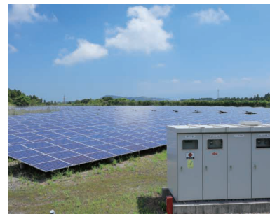
大規模太陽光発電設備(メガソーラーシステム)
