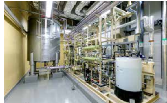
前田薬品工業(株) 立山工場(第1期) 製造用水設備(富山県中新川郡)
