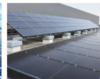
太陽光発電設備 (厚木地区)
