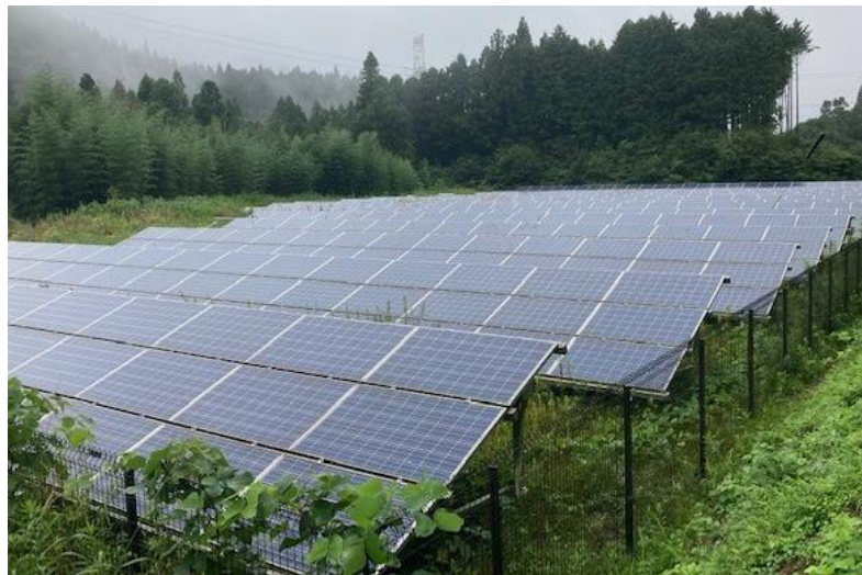
（TESS 福島東白川ソーラー発電所）
