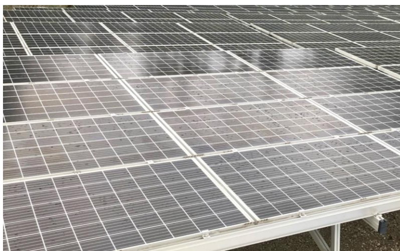
(TESS 兵庫朝来ソーラー発電所)
