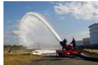
大容量泡放水砲（大分製油所）
