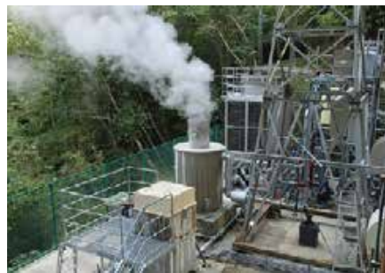
下田温泉バイナリー発電所
