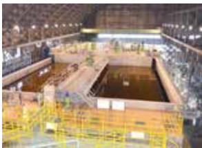
豊羽鉱山 本山坑廃水処理場の様子
