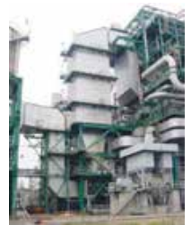
排煙脱硝装置
