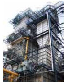
排煙脱硫装置
