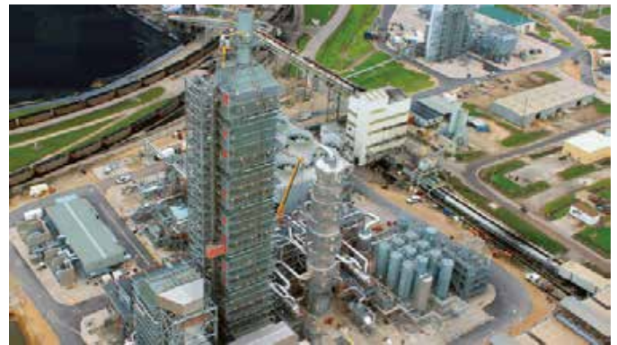
CO 2 回収プラント（米国テキサス州）
