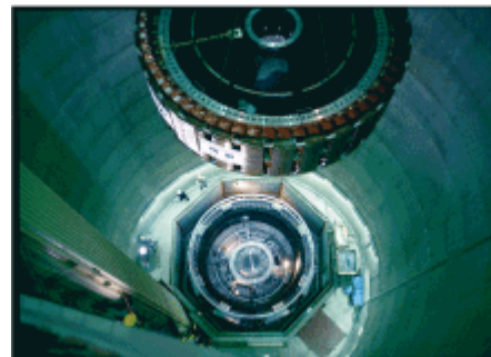
水力発電設備
