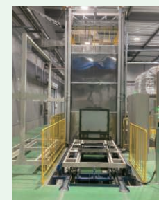
脱脂処理設備
