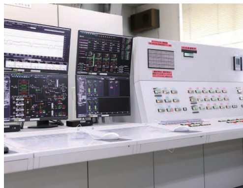
DCS (監視制御システム)
