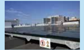
横浜事業所に設置された太陽光パネル
