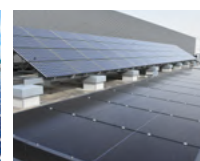
太陽光発電設備 (厚木地区)
