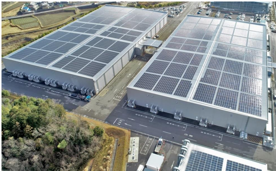
（第 1 期の発電を開始した DMG 森精機 伊賀事業所の太陽光発電パネル）
