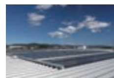
大阪・茨木5号配送センター 太陽光発電設備
