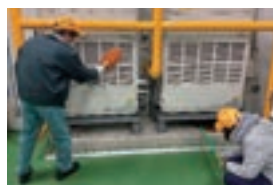
空調ユニット下
