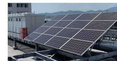
本社屋上設置の太陽光パネル
