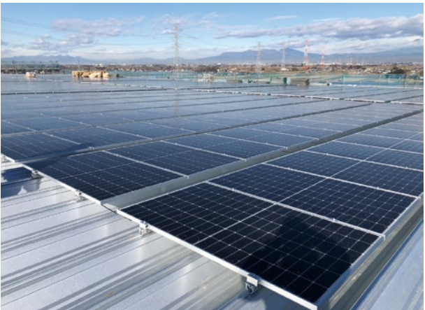
太陽光パネル
