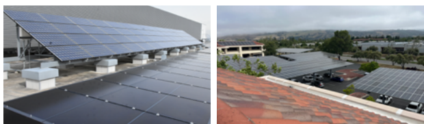
厚木地区の太陽光発電設備
