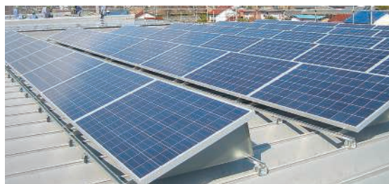
太陽光発電設備
