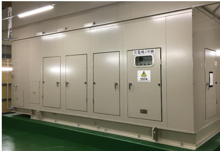
よつ葉乳業 根釧工場 自家発電設備
