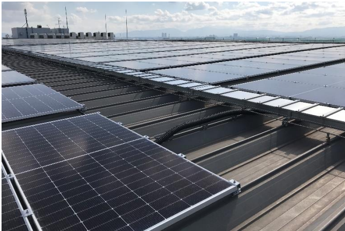
GLP 大阪ソーラー発電所
