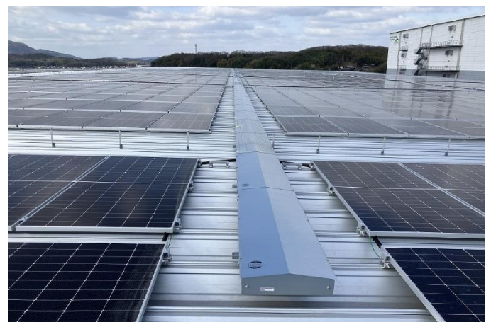
GLP 岡山総社IIIソーラー発電所
