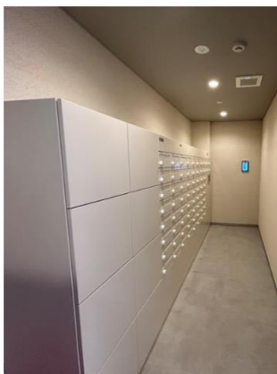
▲ 宅配ボックス
