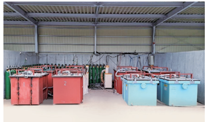
粒状化再生骨材の炭酸化設備
