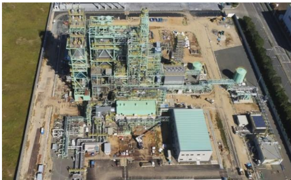
発電所全景（南側から北側を望む）
