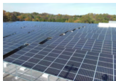
エルナー白河太陽光発電所
