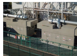
コージェネレーションシステム
