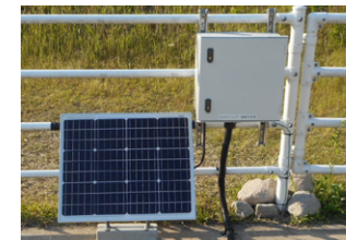
遠隔監視装置盤とソーラーパネル
