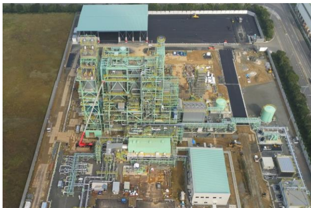
発電所全景（南側から北側を望む）
