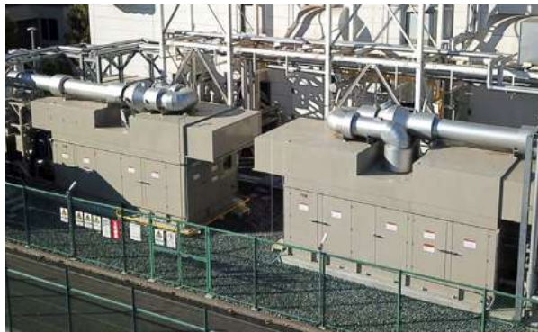
コージェネレーションシステム
