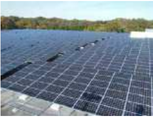
エルナー白河太陽光発電所
