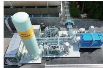
e-methane製造装置
