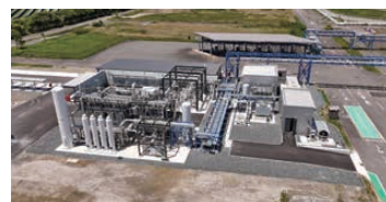
知多緑浜工場水素製造プラント
