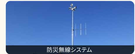
防災無線システム
