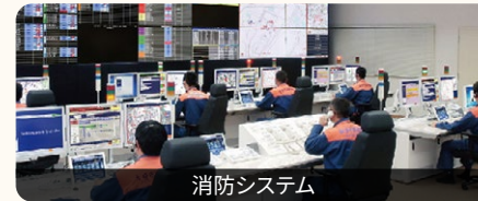
消防システム
