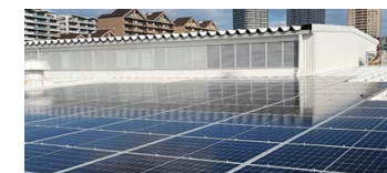
六甲工場の太陽光パネル
