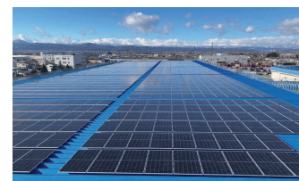
山形工場の太陽光パネル
