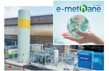
▲知多LNG共同基地で実証試験中のe-メタン製造設備
