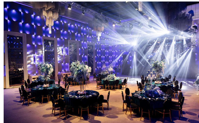
ムービングライト・演出照明施工例
