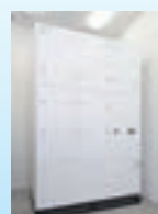
データセンター冷却設備
