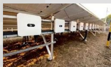
設備運転管理
