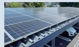
自家消費／カーポート 容量：DC99.84kWAC49.5kW
