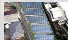
笹野発電所 容量：77kW
